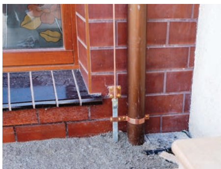
Ввод токоотвода в землю с подключением к металлической трубе и использованием контрольного зажима
