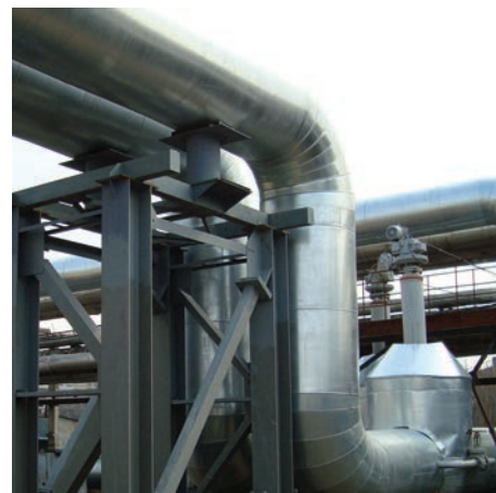
Системы вентиляции, кондиционирования и трубопроводы
