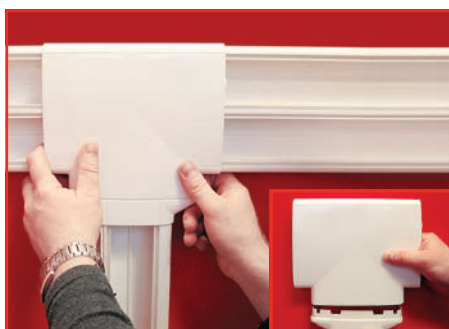
5. Установить переходник При отводе от прямой трассы большого сечения короба меньшего сечения – необходимо вставить под лицевую накладку тройника соответствующий переходник (140-110, 140-90 или 110-90).
